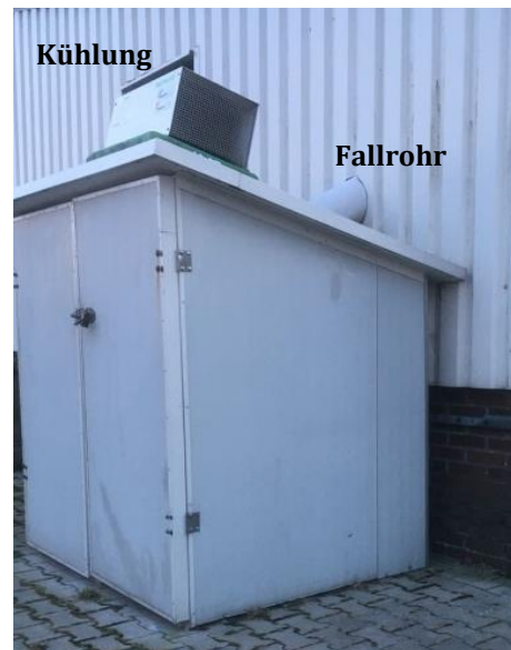
Abbildung 2: Beispiel für ein Ausschleusungssystem mit Außenkühlung ©Langfermann
